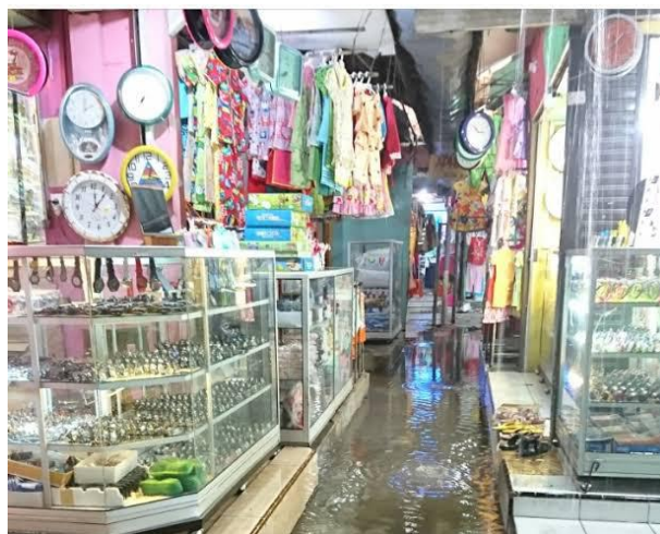
Gambar 2 Keadaan Pasar Kota Bojonegoro Banjir Akibat Atap Bocor
