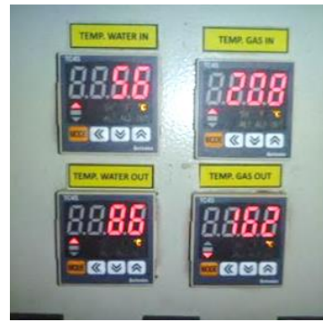
Gambar 6 Panel Indikator Temperatur air dan udara
