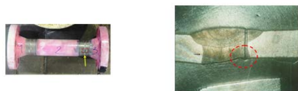
Gambar 4.5 Sambungan Las 1 yang terdapat crack, pembesaran 8 kali
