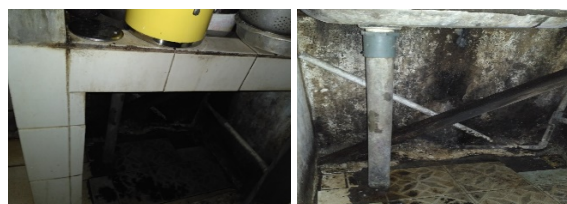
Gambar 4. Bak Kontrol Air Cucian Piring Rumah Tangga
